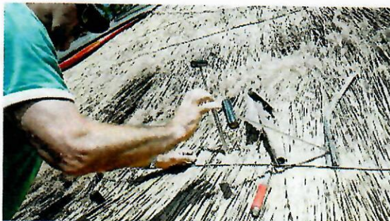
Das Erneuern der defekten Stellen erfordert vom Dachdecker viel Geschick und Fingerspitzengefühl.
